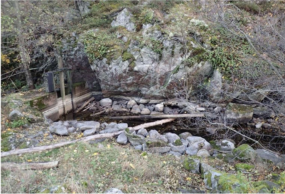
Figur 9. Kronddammen belägen i det vänstra utloppet av sjön Tyresö-Flaten. Tidigare fanns ett skibord till vänster om dammen. Norconsult 2016.
