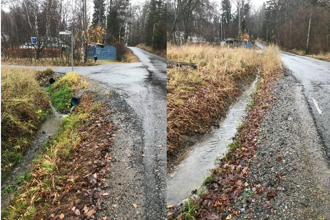
Figur 13. Planområdets gränser till etapp 2 till 6 efter regn. Fotot till vänster visar korsningen Rödhakevägen/Fasanvägen i nordlig riktning. Dagvatten rinner söderut via flertalet vägtrummor från Fasanvägen och Rödhakevägen och leds till Nytorpsvägen. Fotot till vänster visar trummor vid korsningen Rödhakevägen/Fasanvägen. Fotot till höger visar nyanlagt dike längs Rödhakevägen (Foton: Sweco, november 2019).
