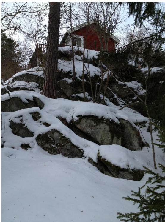
1-155 ogynsamm spricka under huset
