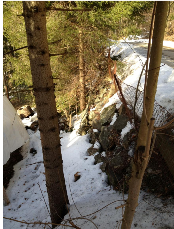
Dy1-9 stenmur i dålig skick
