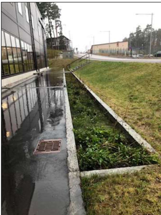
Figur 9. Exempel på nedsänkt regnbädd där dagvatten från taket leds till regnbädden (Foto: Norconsult).
